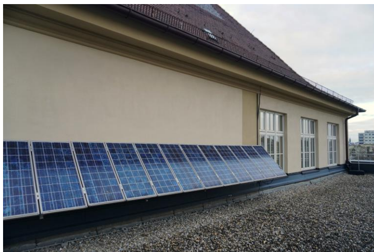
Abb.: Solarzellen am Dach
